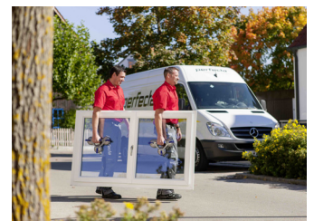
Der saubere Austausch der alten Modelle funktioniert nicht nur mit Fenstern, sondern auch mit Türen. Die Methode „Wechsel ohne Dreck“ wird seit über 40 Jahren von qualifizierten perfecta-Mitarbeitern ausgeführt. (Foto: epr/perfecta)
